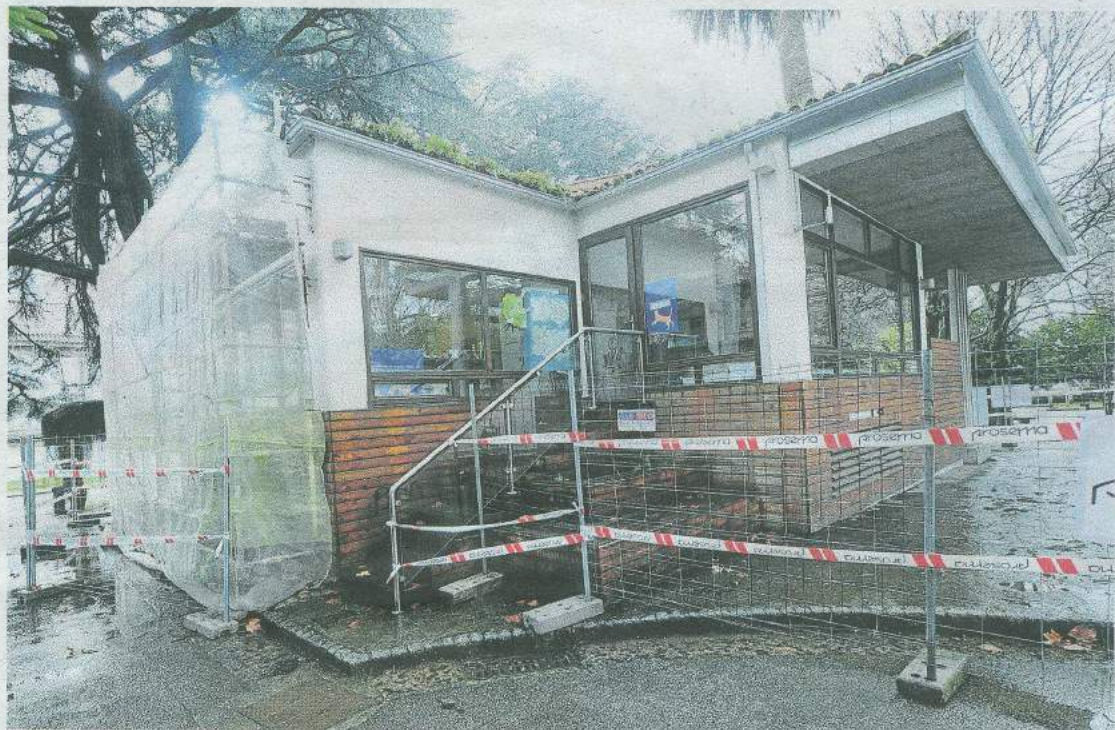
A pesar de las obras de los últimos años, las condiciones en la Casa do Xadrez no eran óptimas
